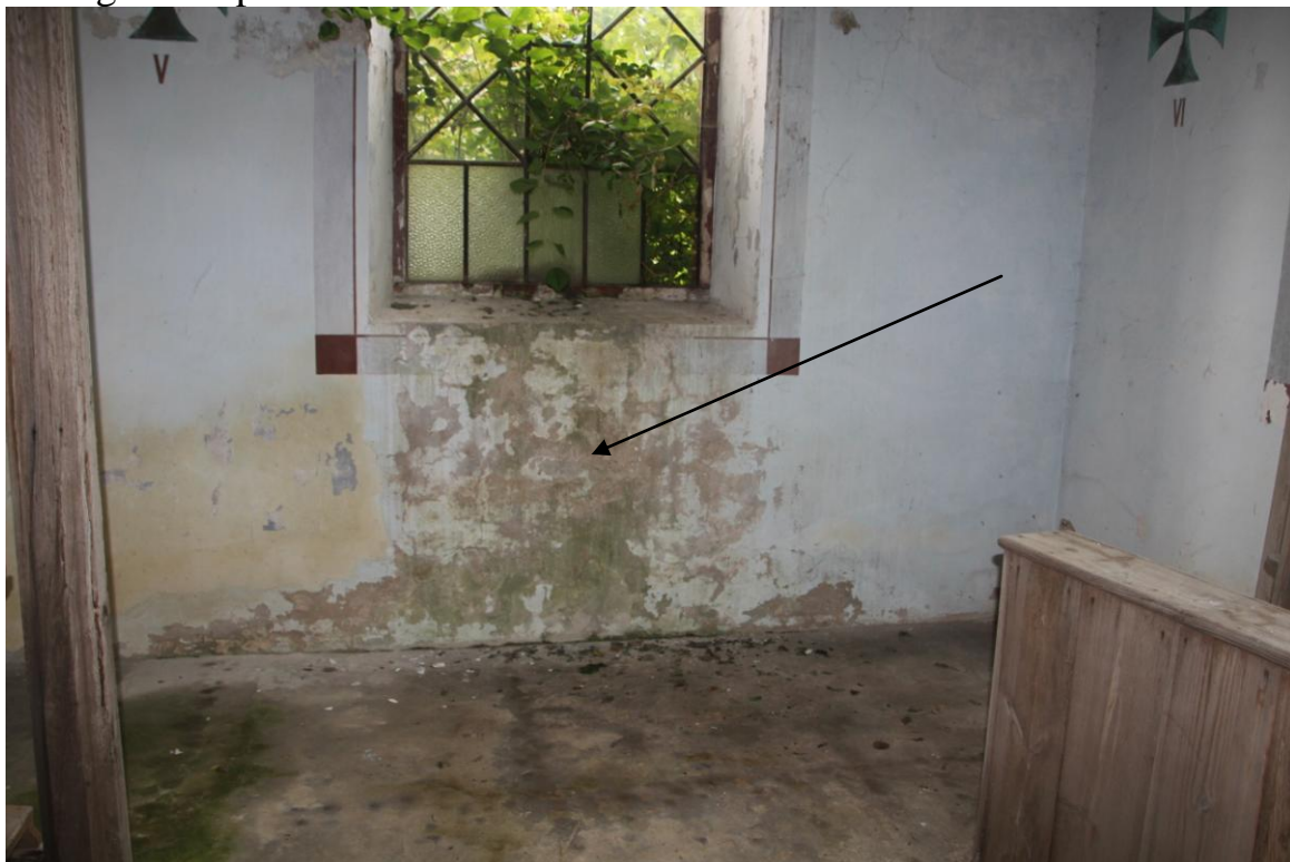
zawilgocenie pod oknem
