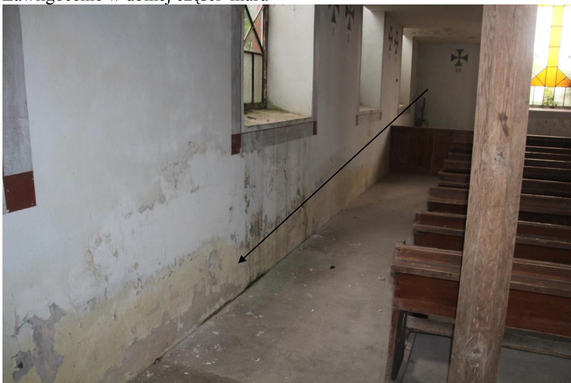
Zawilgocenie w dolnej części muru
