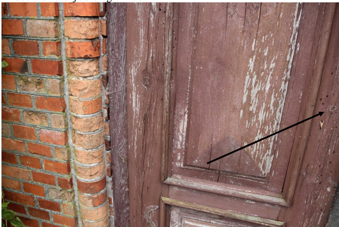
Widoczna korozja biologiczna drzwi
